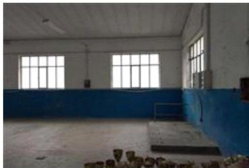
Presa fotografica interna che descrive la presenza dell'impianto elettrico privo della dichiarazione di conformità.
