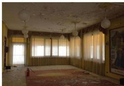
Vista di una porzione della sala ristorante in cui si evidenziano diffuse esfoliazioni dello strato corticale interno dell'intradosso del solaio superiore.
