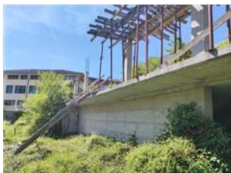
Struttura in c.a. del piano interrato e pilastri del piano terreno del fabbricato che non risulta essere stato ultimato.
