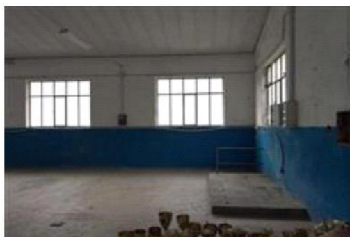
Presenza fotografica interna che descrive la presenza dell'impianto elettrico privo della dichiarazione di conformità.
