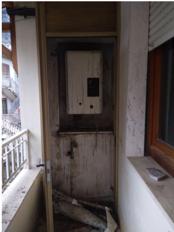
Caldaia a gas metano dismessa
