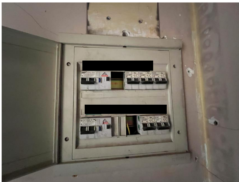
Foto 20. - Quadro elettrico vetusto e non a norma
