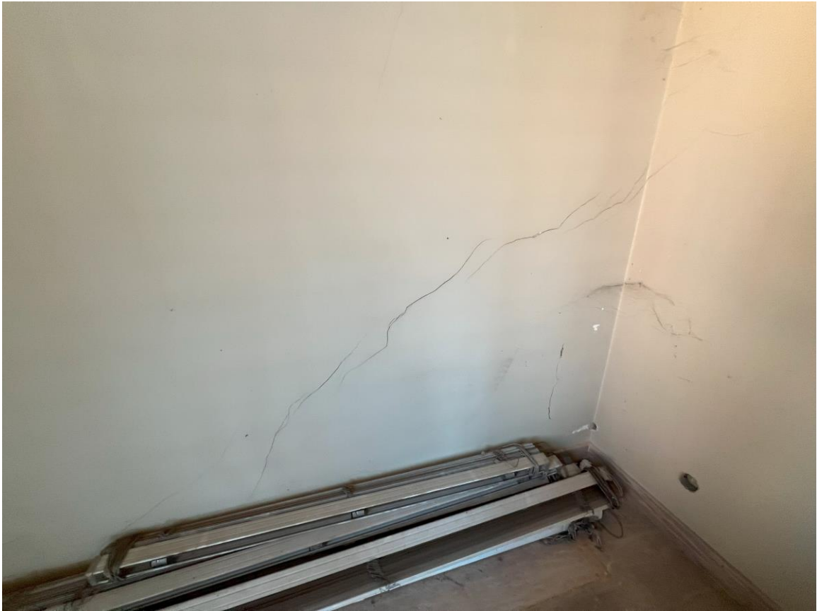
Foto 14. - Particolare pareti con lesioni
