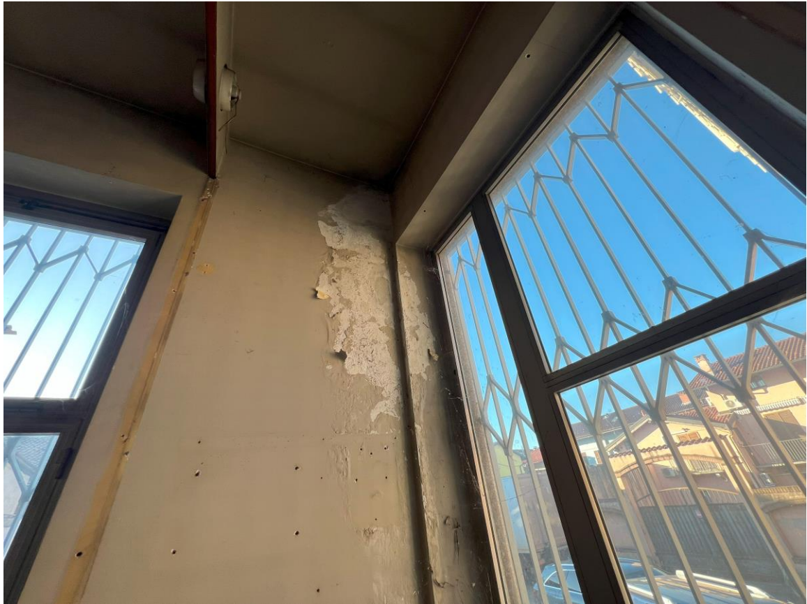
Foto 8. - Particolare pareti con esfoliazioni
