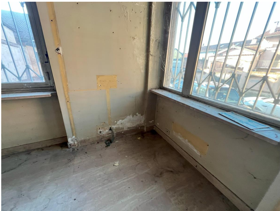
Foto 7. - Particolare pareti con esfoliazioni
