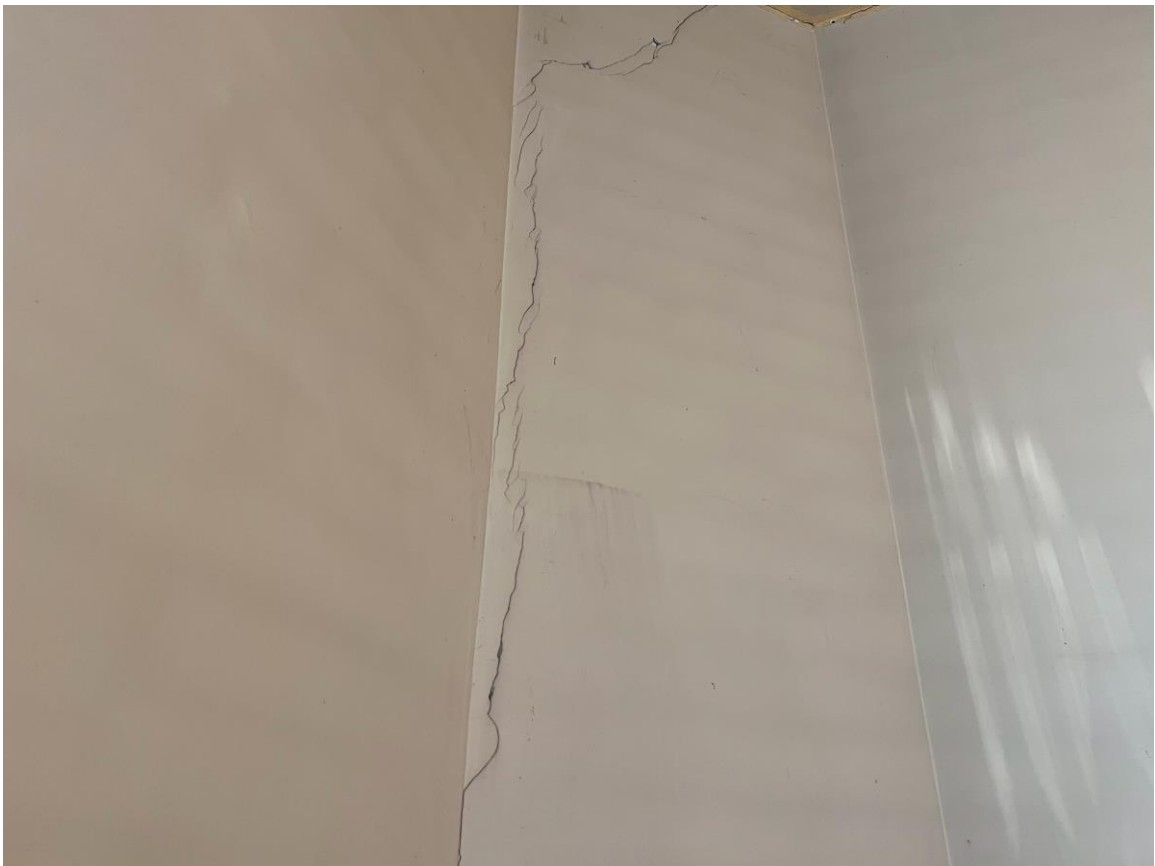
Foto 15. - Particolare pareti con lesioni
