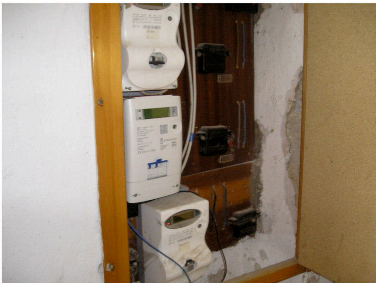
FOTOGRAFIA 14 - Vano Comune Contatori Enel P.T.
