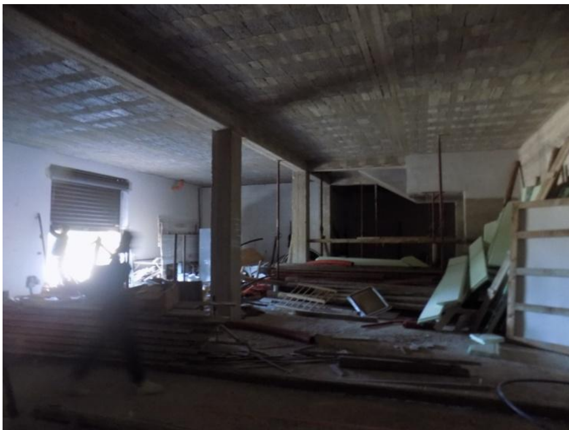
LOTTO UNO: Vista d'insieme degli interni dell'ampio Locale terraneo in stato grezzo.
