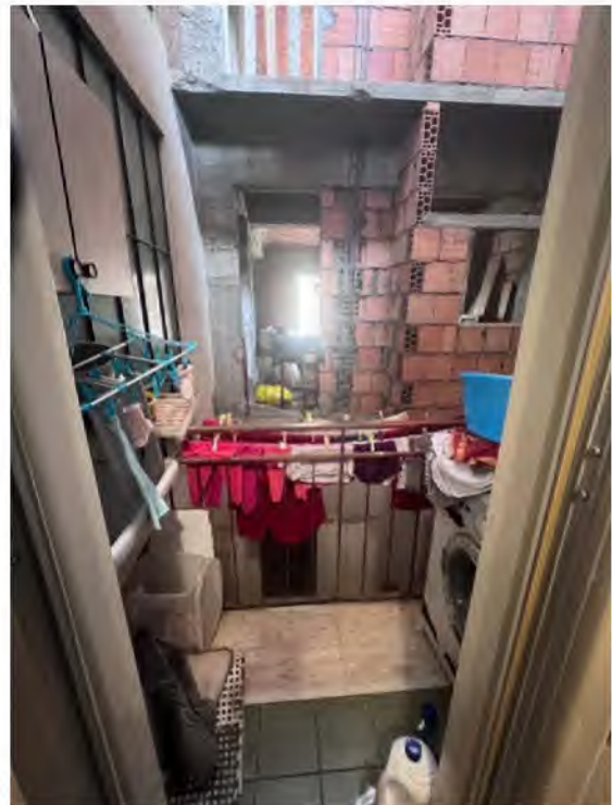
Foto 13. Pozzo luce con ampliamento non regolarizzato
