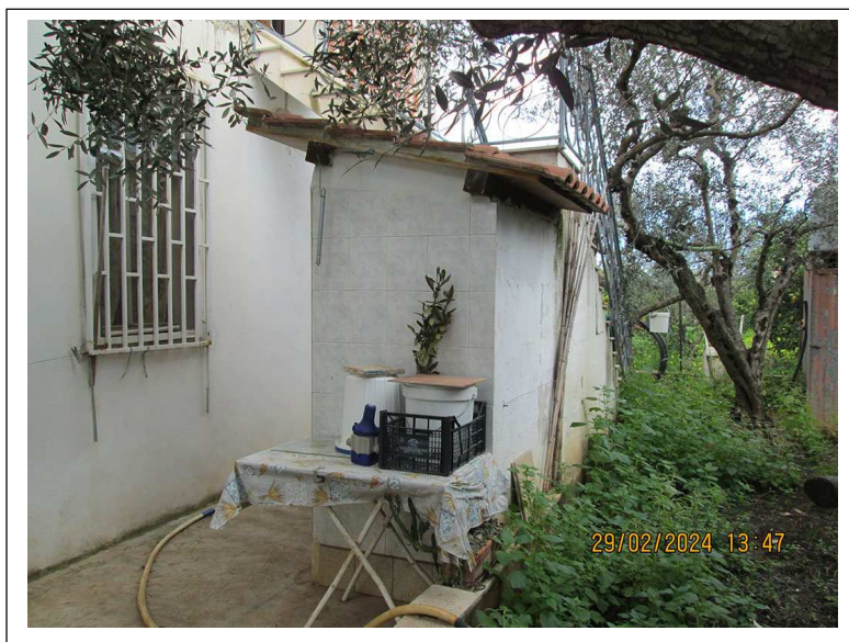
Foto n. 39. Corpo edilizio a confine con la scala di accesso al piano primo.
