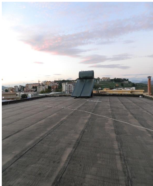
Particolare Copertura di pertinenza con solare Termico
