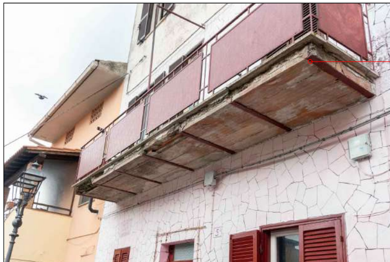
Particolare del Sottobalcone Ammalorato
