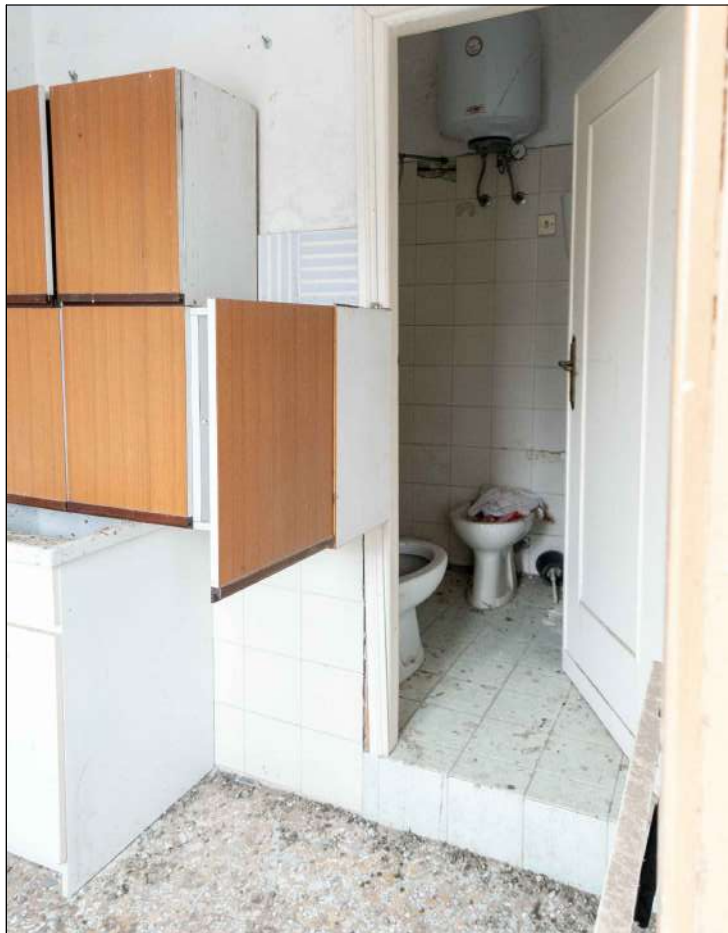
- Bagno al Piano Primo -
