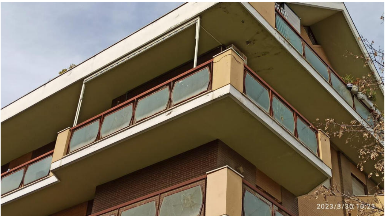
Foto n. 19 – Ammaloramenti dei frontalini e balaustre balconi
