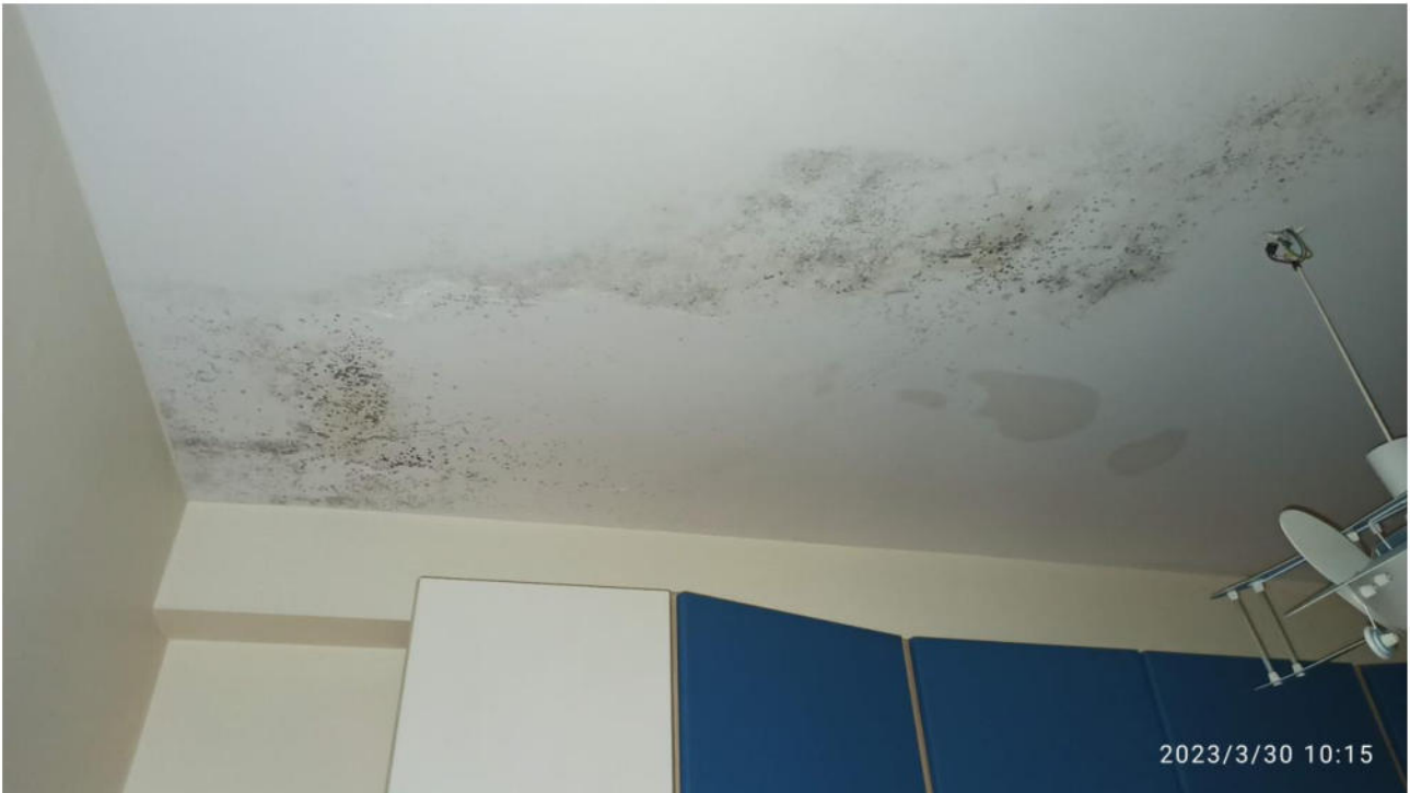
Foto n. 14 – Muffe sul solaio della Camera
