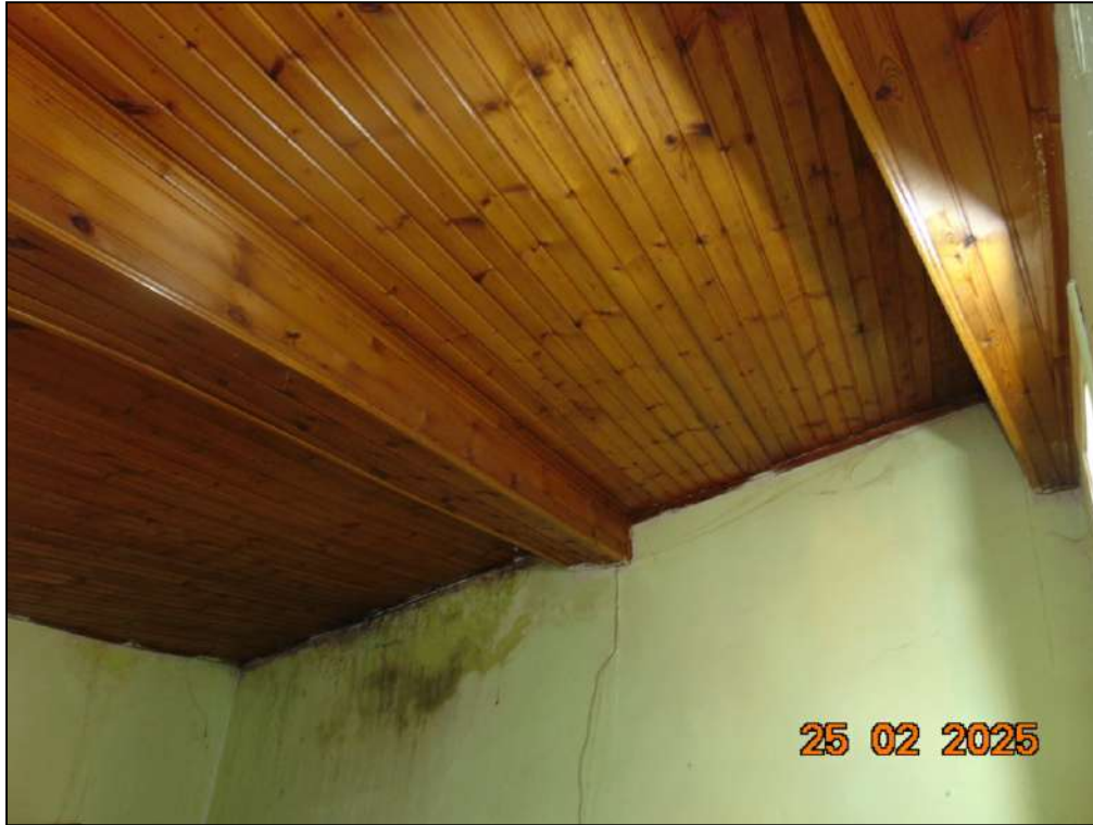
Figura 16 – Dettaglio solaio di copertura – infiltrazioni
