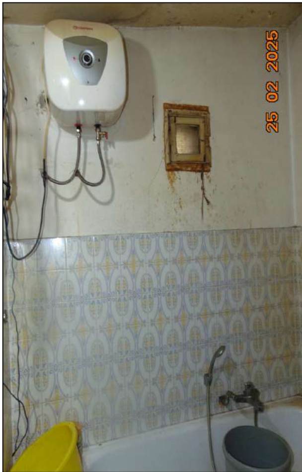
Figura 19 – Dettaglio finestra bagno – bene n.1
