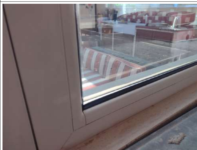
Particolare infisso scorrevole ex loggia p1 sub 8 volume non autorizzato
