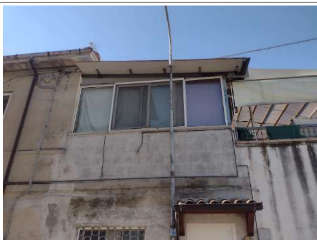
Part. Prospetto nord porzione volume loggia tamponata stato non autorizzato
