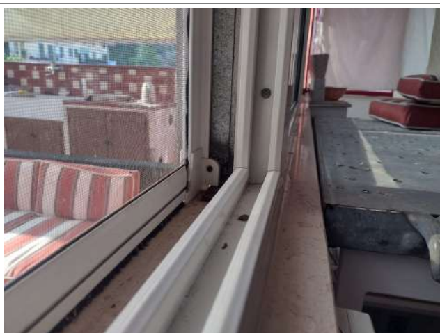
Particolare infisso scorrevole ex loggia p1 sub 8 volume non autorizzato
