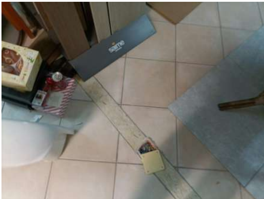
Pavimentazione discontinua a seguito della demolizione dei tramezzi
