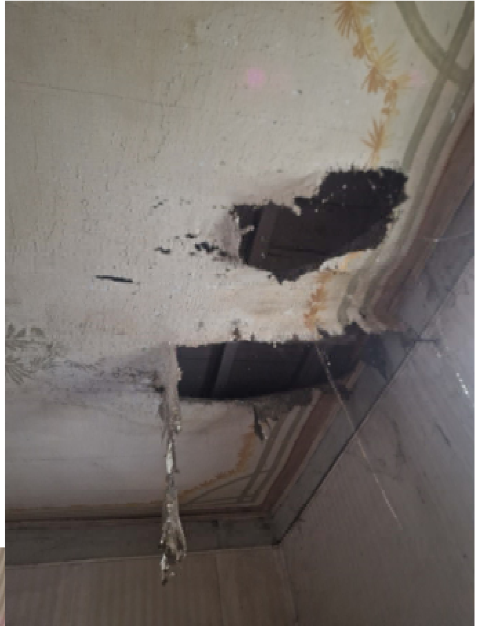
16: SUB 15 CAMERA DETTAGLIO LACUNE NEL SOFFITTO IN CANNUCCIATO
