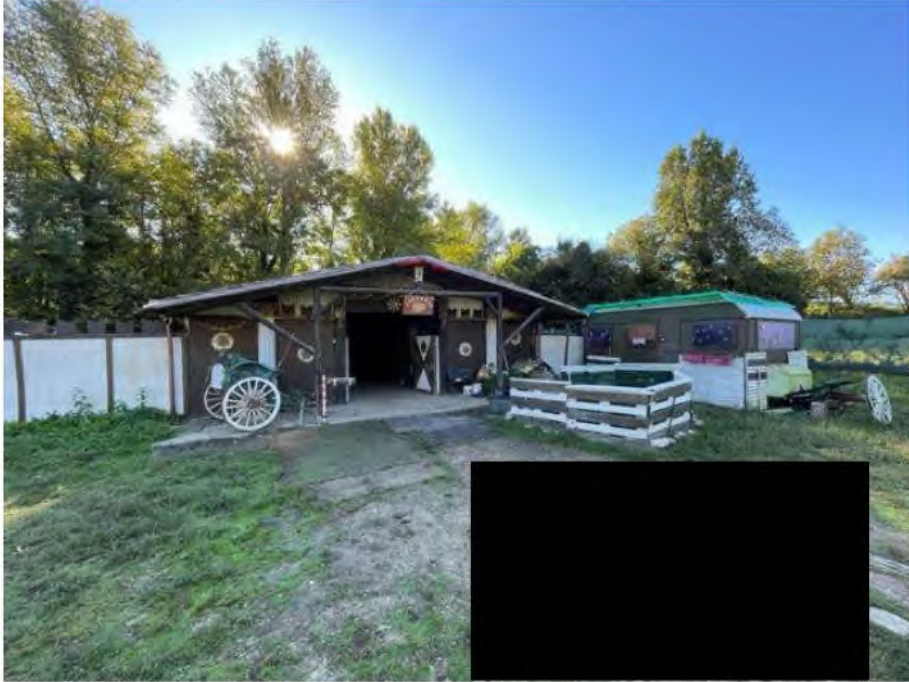
Fot. N. 32: Costruzione precaria non autorizzata per allevamento di animali realizzata su part. 60
