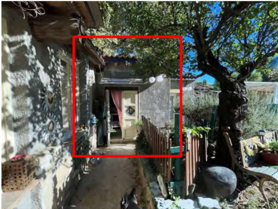
Fot. N. 25: Pertinenza – ampliamento abusivo (vista lato sud)
