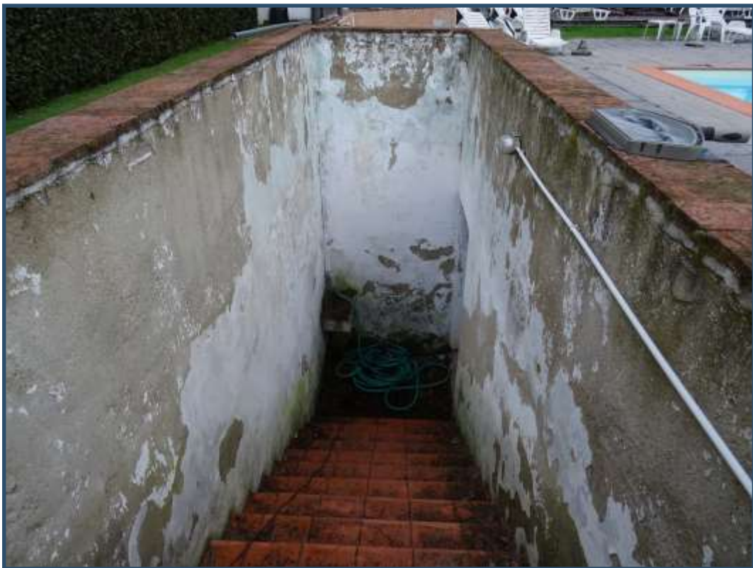
FOTO 15 ACCESSO AL LOCALE TECNICO DELLA PISCINA
