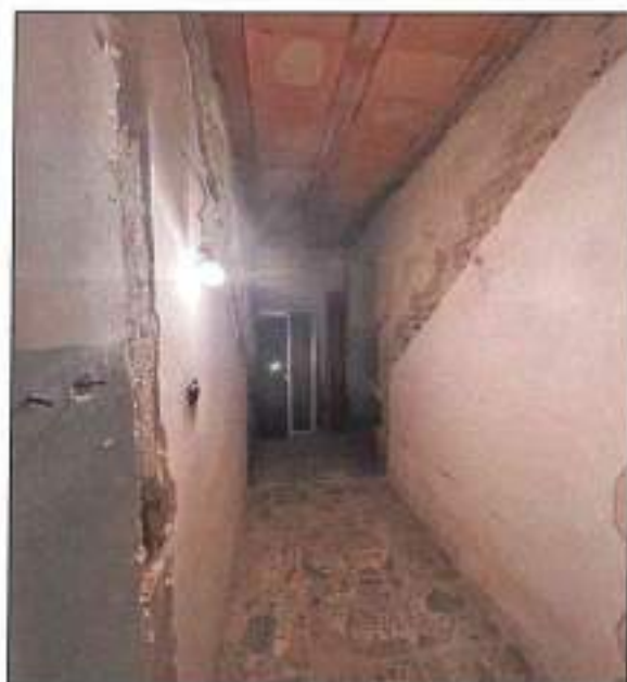
Foto n° 50 –vita interna locale corridoio al piano S1, con lavori di risassi sospesi allo stato rustico e non ancora terminati.
