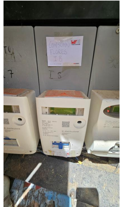
Vista allaccio contatore rete elettrica
