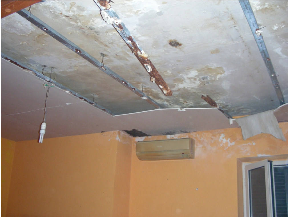
Foto n.29: Controsoffittatura caduta in cameretta
