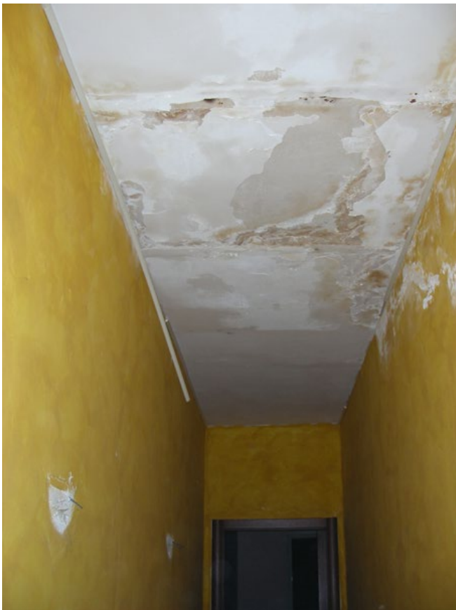
Foto n.30: Tracce di infiltrazioni dal terrazzo nel corridoio
