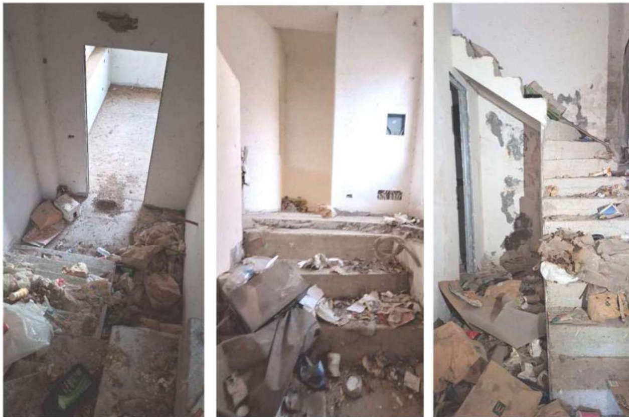
Vista della scala in c.a. che collega piano terra e piano seminterrato con vista della porta ripostiglio
