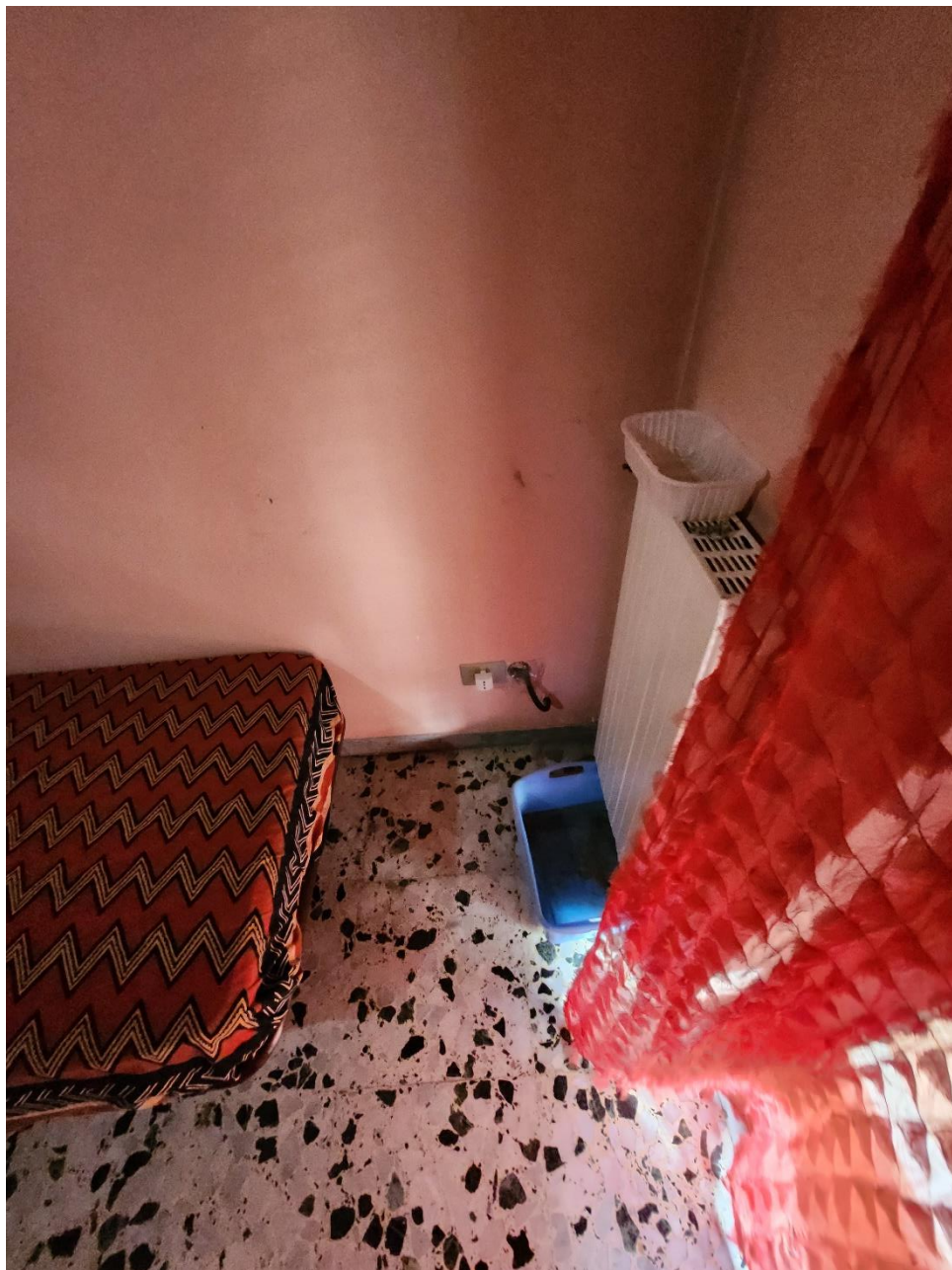
Foto in cui si evidenzia un problema al termosifone.
