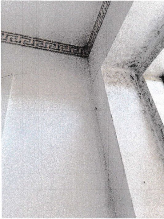
Foto 22: umidità vano scala
