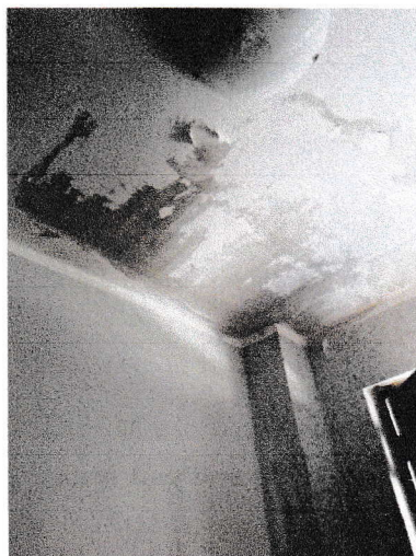
Foto 3: umidità vano scala
