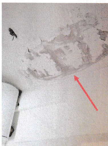
Foto 10: umidità soffitto vano WC
