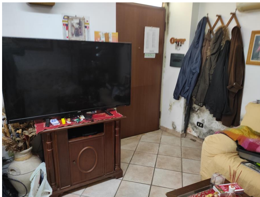
Vista parziale interna dell'ingresso sala da pranzo in cui si evincono le rifiniture e le macchie di umidità.
