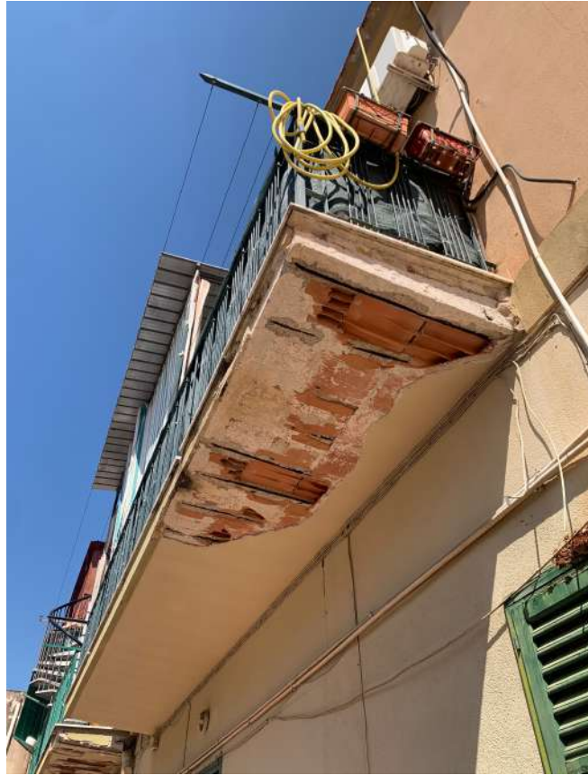
Foto n. 6 - Stato del balcone laterale
