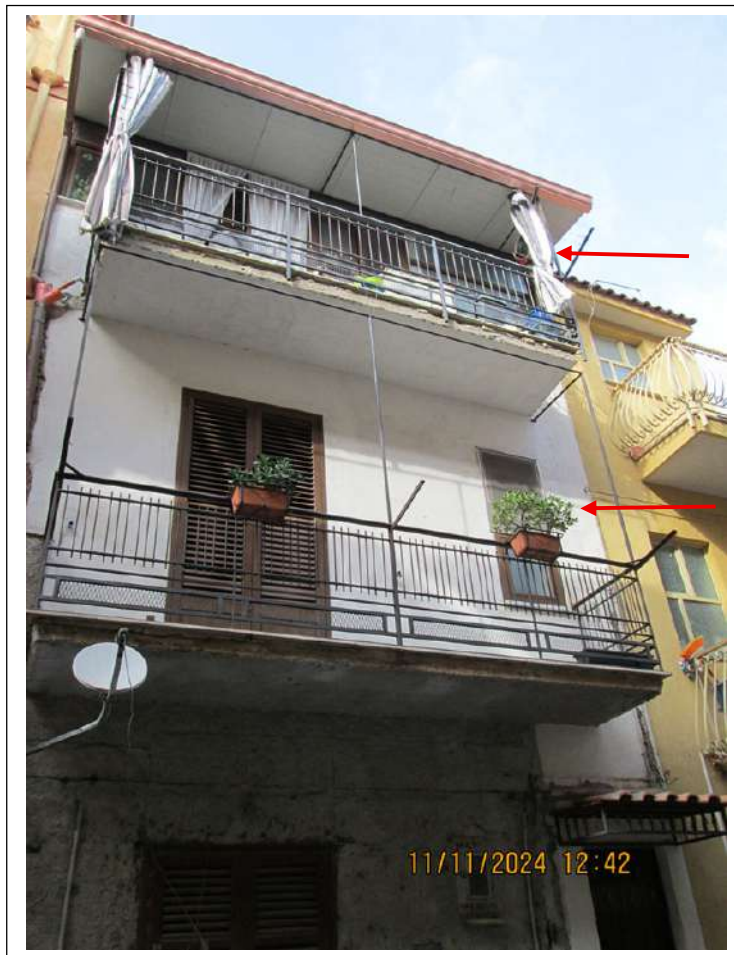
Foto n. 2. Prospetto su via Vittorio Veneto. Con le frecce sono indicati i balconi del primo e secondo piano
