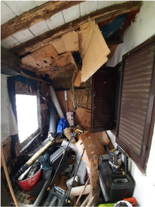
Manufatto abusivo da rimuovere
