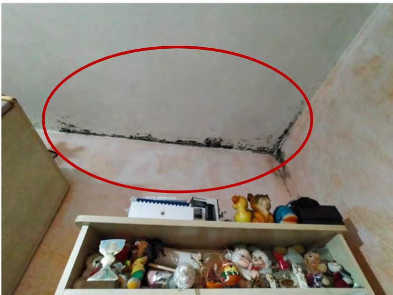
FOTO 26- CAMERA, PARTICOLARE MACCHIE DI UMIDITÀ
