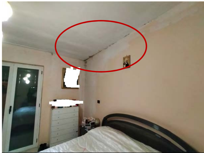
FOTO 21- CAMERA, VISTA MACCHIE DI UMIDITÀ
