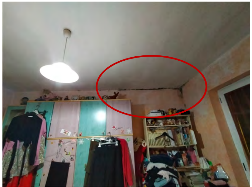
FOTO 25- CAMERA, VISTA MACCHIE DI UMIDITÀ
