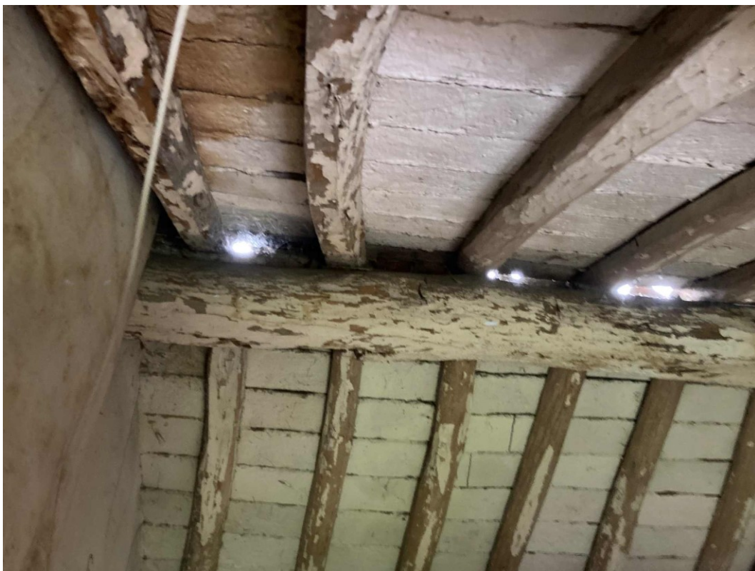
Foto 10 – Infiltrazioni dal sottotetto
