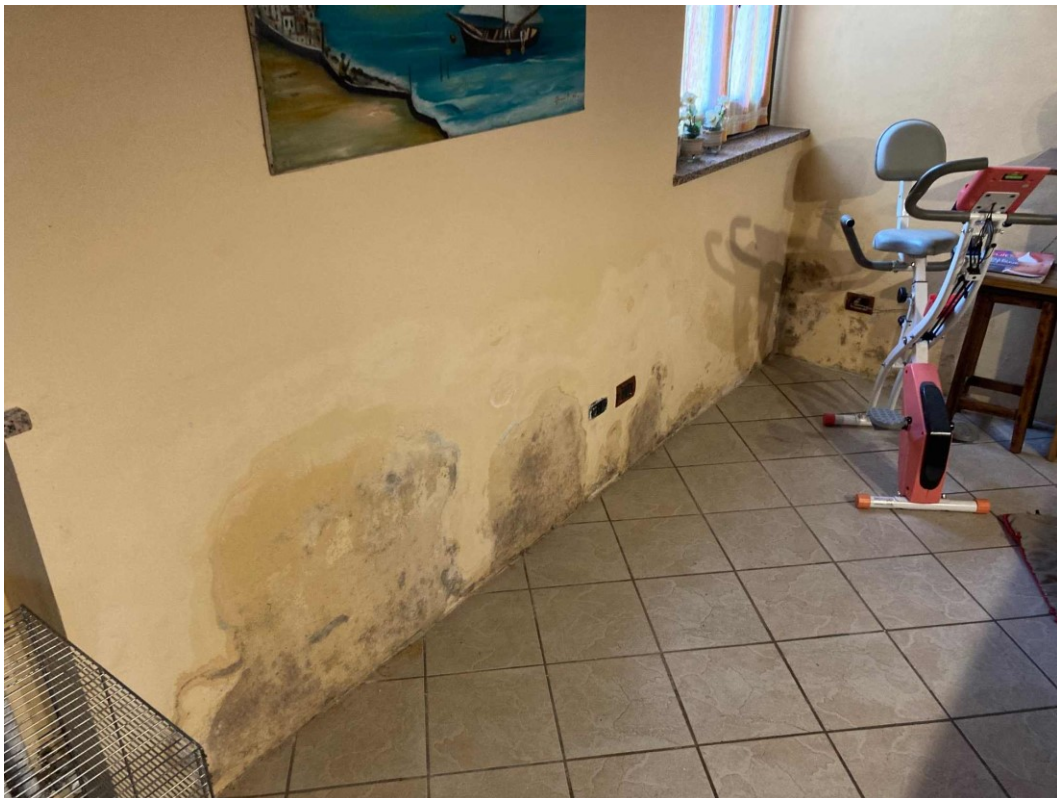
Foto 6 – Umidità di risalita al PT
