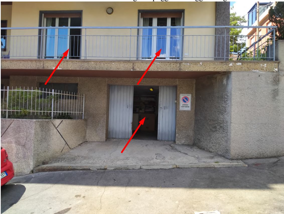
FOTO 4 – facciate stabile civ. 78 di via Romagna – poggiolo alloggio e ingresso al vano “cantina”
