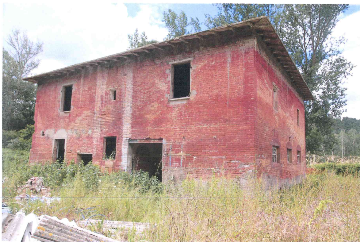
Foto n. 6 Il fabbricato B non accessibile
