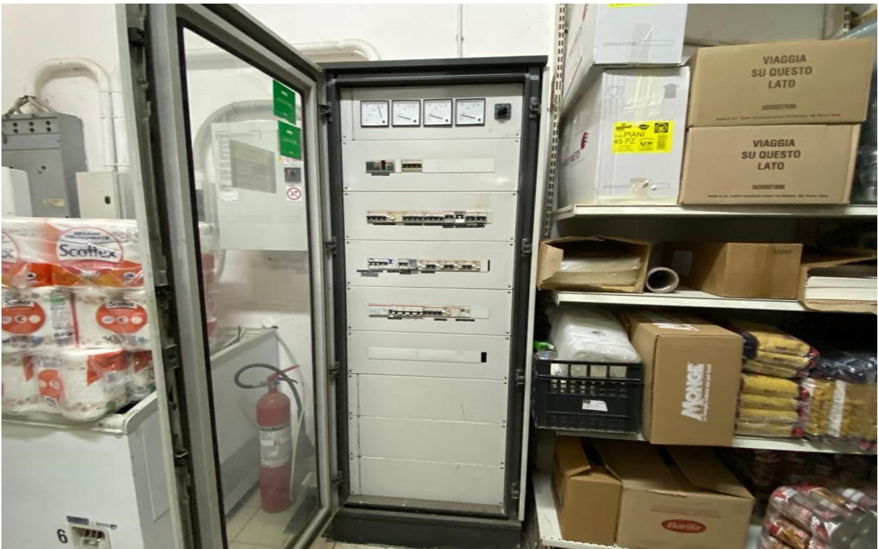
FO 28: quadro elettrico;
