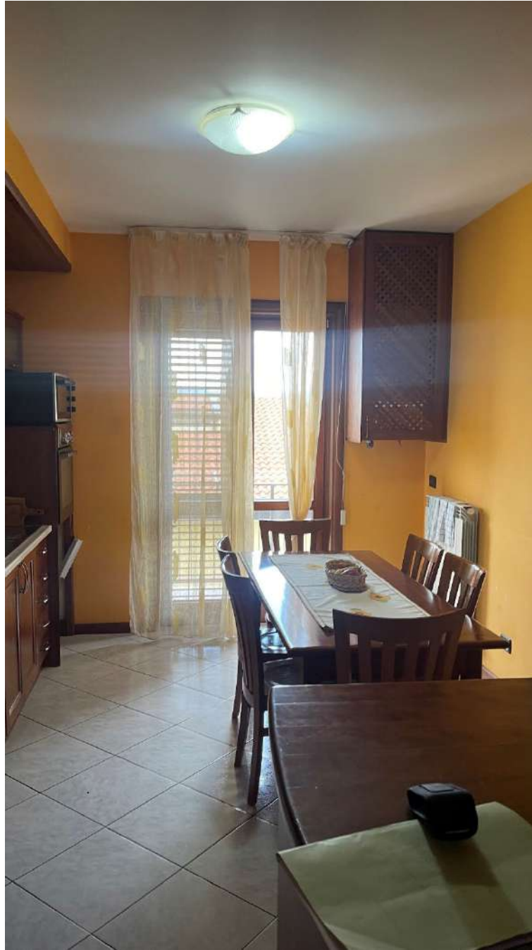
foto n. 6 interno cucina – assenza di tramezzo rispetto alla planimetria catastale
