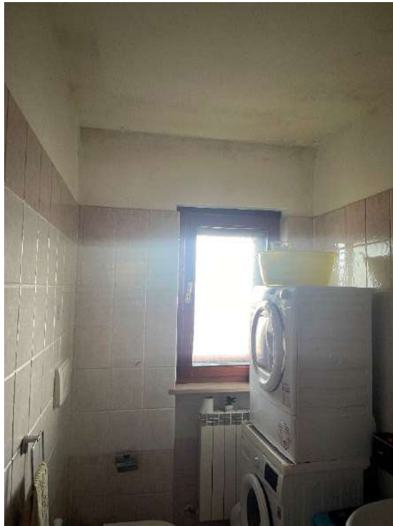
foto n. 7 interno bagno di servizio – tracce di umidità
