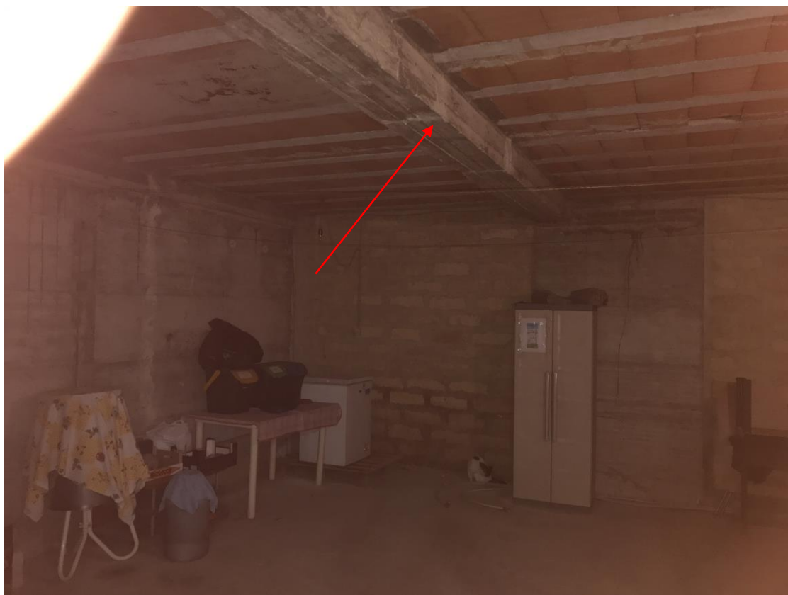
Foto interno garage con in alto la trave corrispondente alla tramezzatura abbattuta abusivamente
