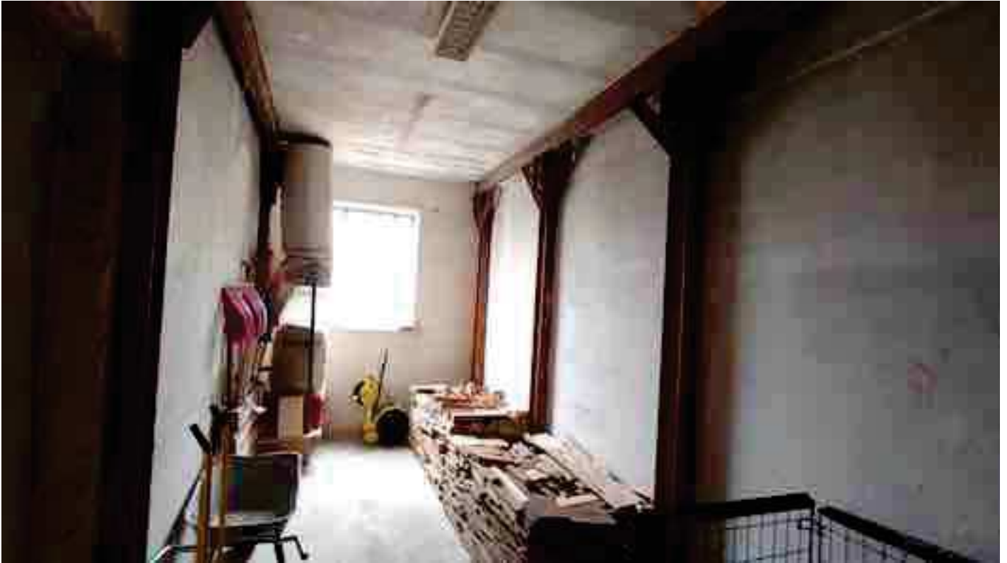
LOCALE COMUNE A TUTTI I SUBALTERNI DELLA PARTICELLA N. 267 - LOCALE CALDAIA
