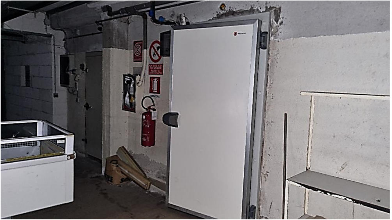
CELLE FRIGORIFERE MAGAZZINO PIANO INTERRATO
