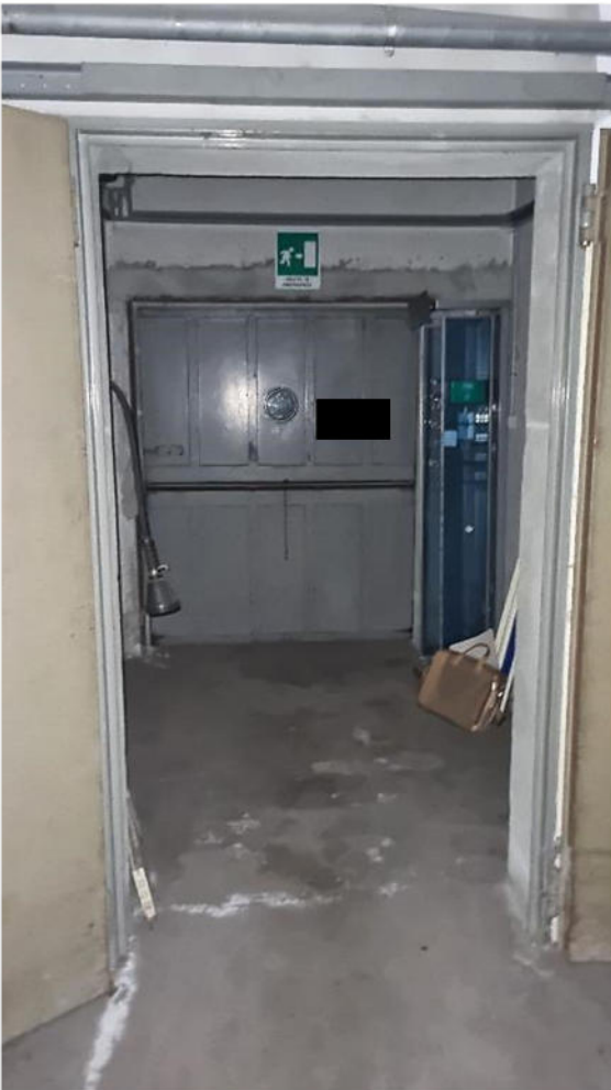
MONTACARICHI PIANO INTERRATO (MAGAZZINO)
