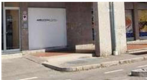
botola accesso cabina Enel interrata
