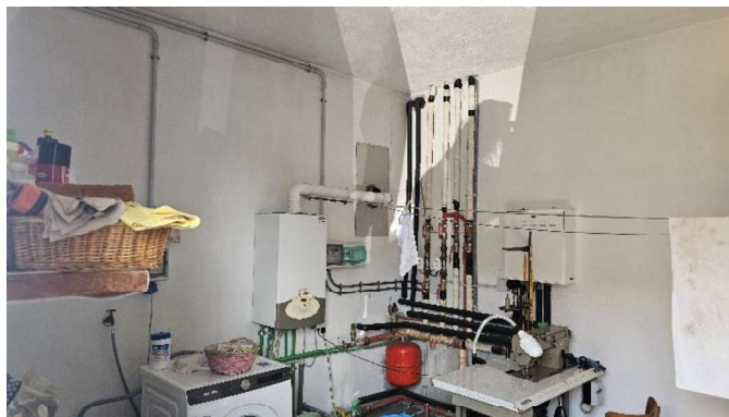
Foto 13 – Locale caldaia (punto A)
