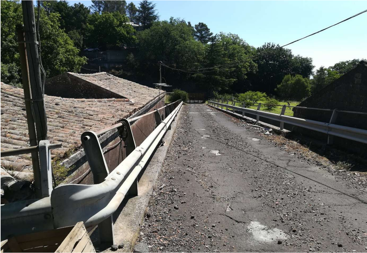
PARTICOLARE DELLA UBICAZIONE DEL VIADOTTO IN RIFERIMENTO AI CORPI DI FABBRICA PRINCIPALI
