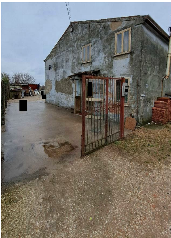
Figura 3: Passaggio di accesso all'immobile tramite cancello carraio e pedonale dal mappale n. 46, come rilevato in sede di sopralluogo e veduta abitazione prospetto est
