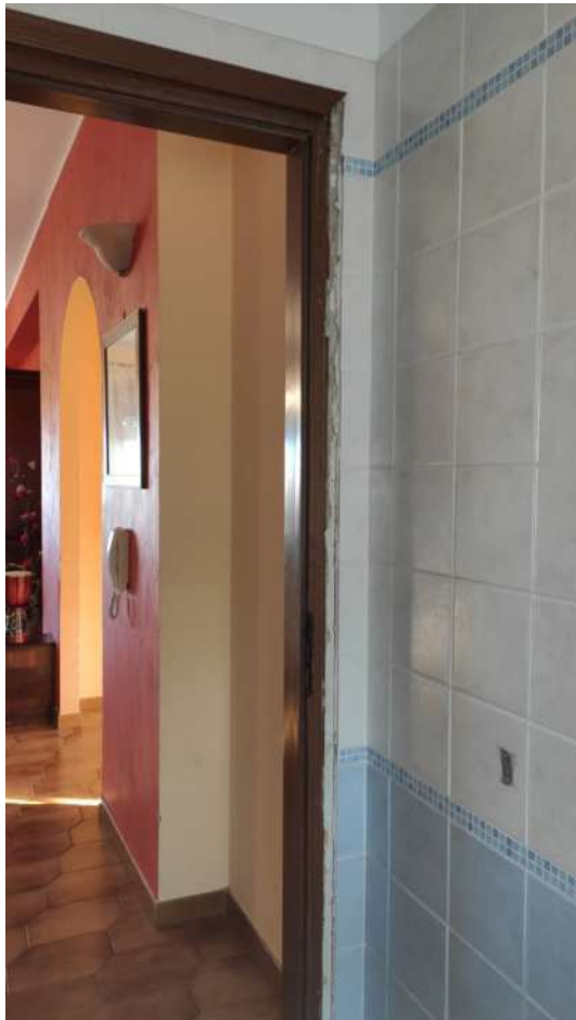
FOTO N. 22: Vista della porzione di cornice della porta del bagno mancante
