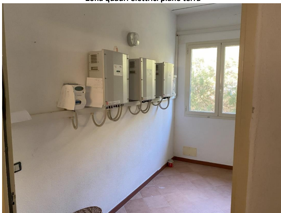
Inverter fotovoltaico 20 Kw ubicati nel vano scale al piano primo
