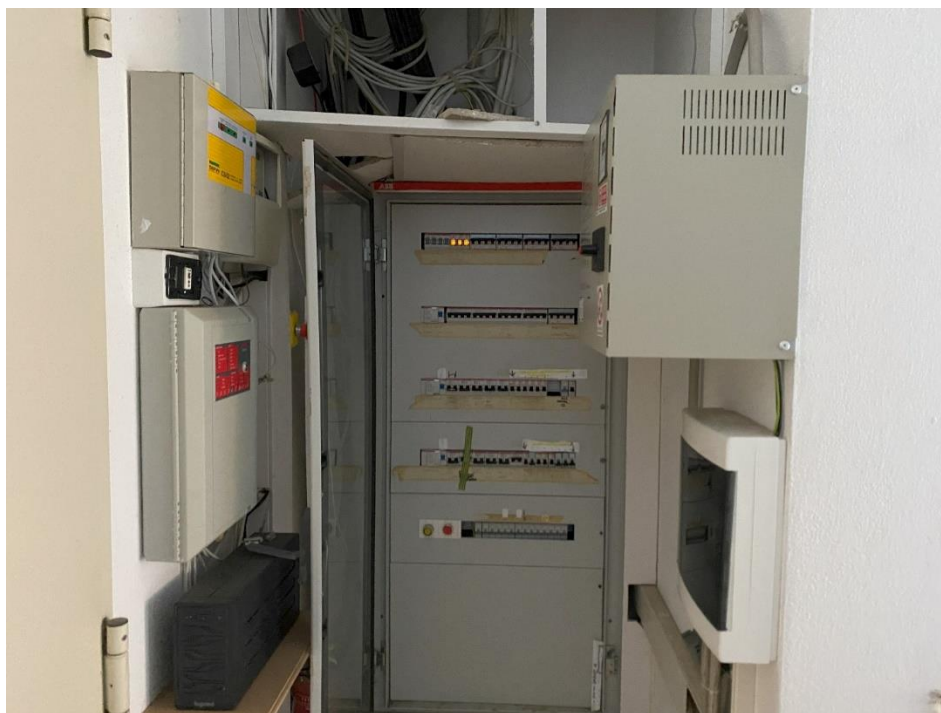
Zona quadri elettrici piano terra
