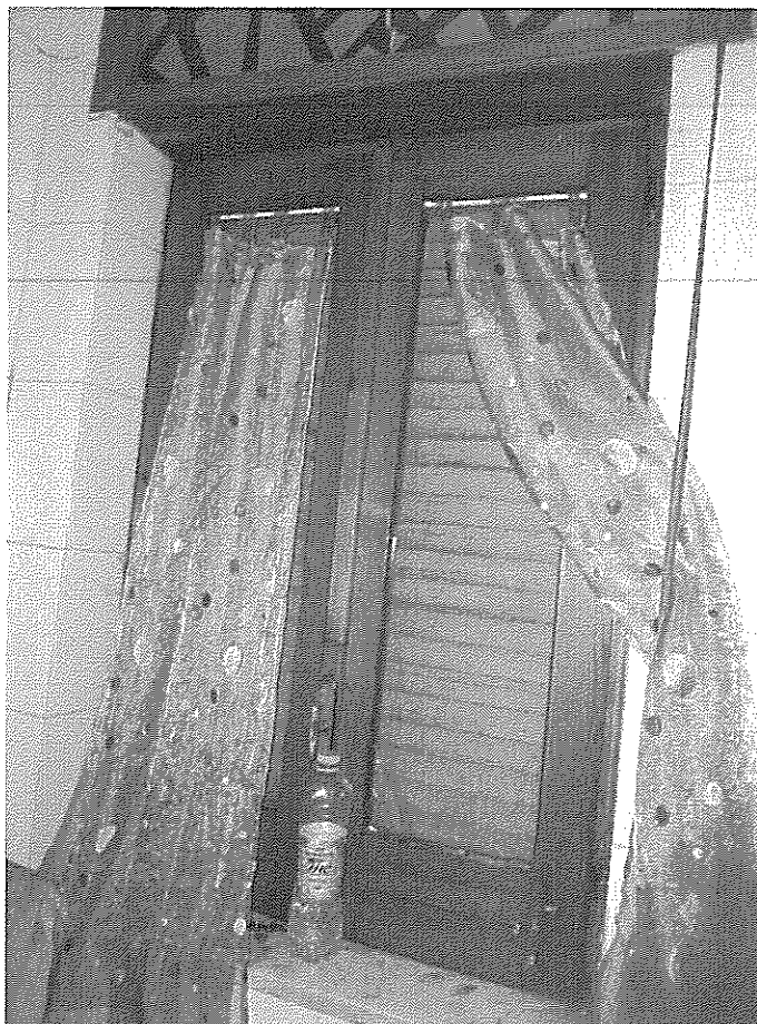
Foto n. 23 <WC zona notte - In evidenza tipologia di infissi esterni in legno con tapparelle in pvc - All. N. 3>
