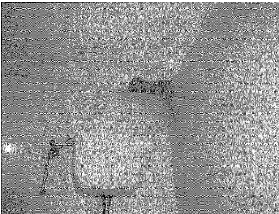
Foto n. 23 <WC zona notte - In evidenza presenza di infiltrazioni - All. N. 3>
