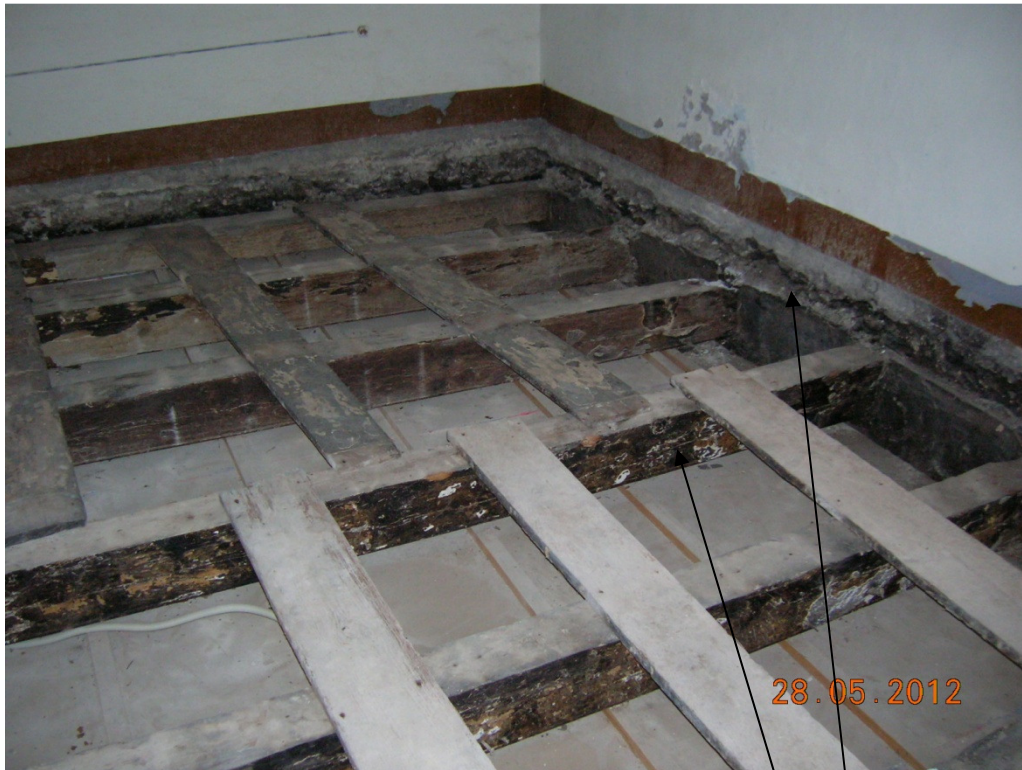
FOTO N. 07 STRUTTURA DEL SOLAIO (TRACCE DI UN PROBABILE INCENDIO PREGRESSO)
