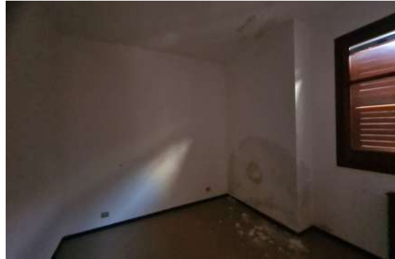
Foto n. 53 Vano letto singolo-Tracce di umidità
