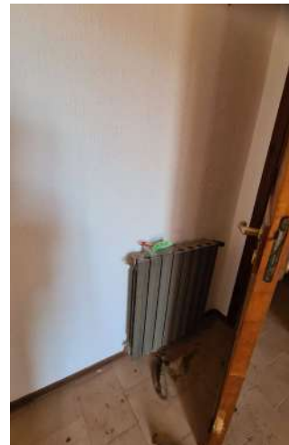
Foto n. 59 Vano letto Pannello radiante in ghisa
