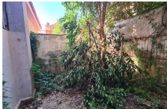
Foto n. 34 Terrazzo a livello-Muretti di recinzione oggetto di istanza di condono
