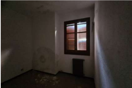
Foto n. 52 Vano letto singolo- Tracce di umidità
