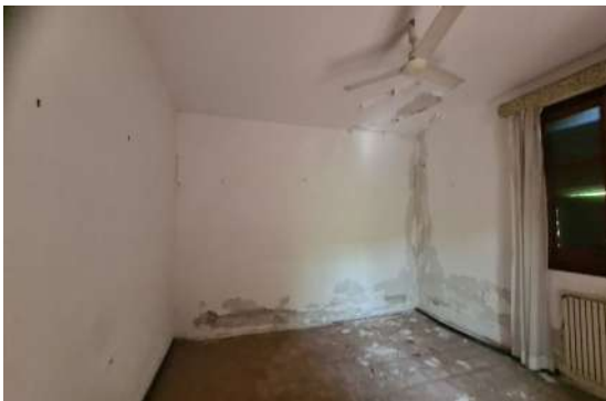
Foto n. 13 Ingr./salone- macchie di umidità lungo le pareti e il soffitto
