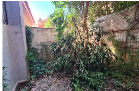
Foto n. 34 Terrazzo a livello-Muretti di recinzione oggetto di istanza di condono
