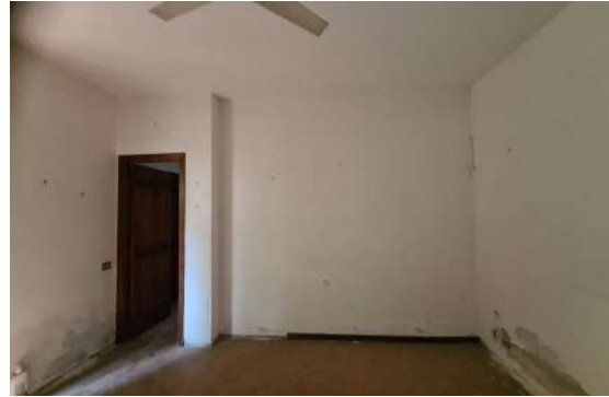
Foto n. 14 Ingr./salone – macchie di umidità lungo le pareti
