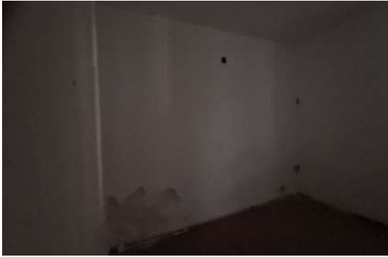
Foto n. 23 Soggiorno - macchie di umidità
