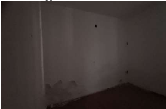
Foto n. 23 Soggiorno - macchie di umidità
