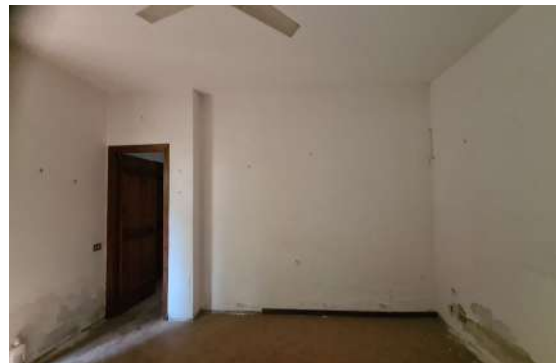
Foto n. 14 Ingr./salone – macchie di umidità lungo le pareti
