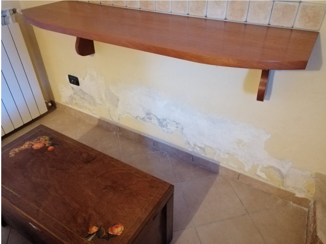
Foto 21 – Umidità di risalita nella cucina al piano terra.
