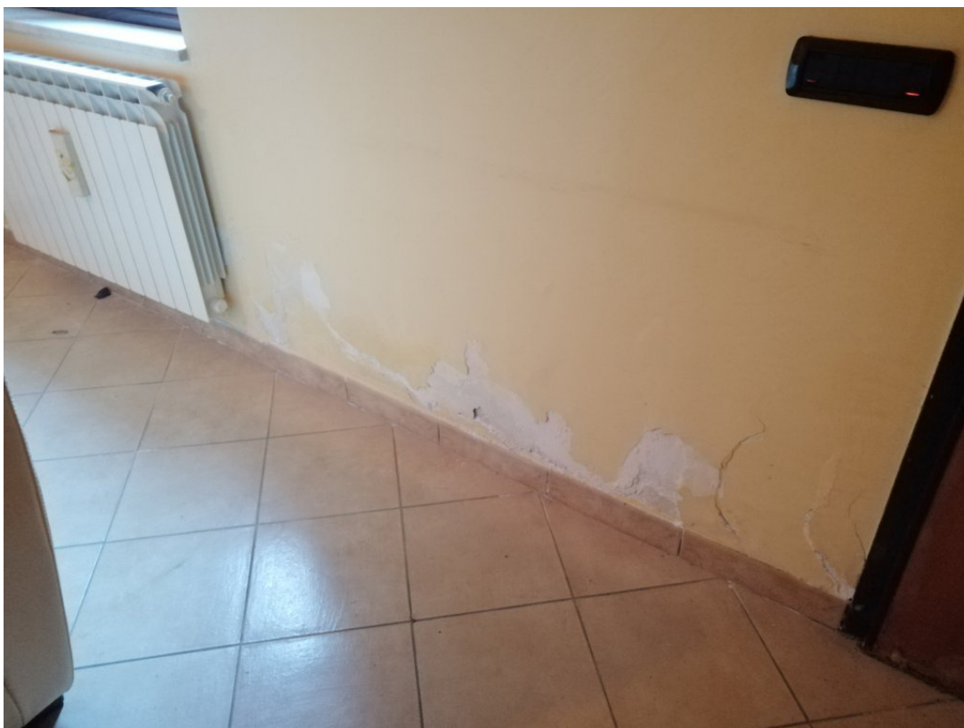
Foto 19 – Umidità di risalita nell'ingresso/soggiorno al piano terra.
