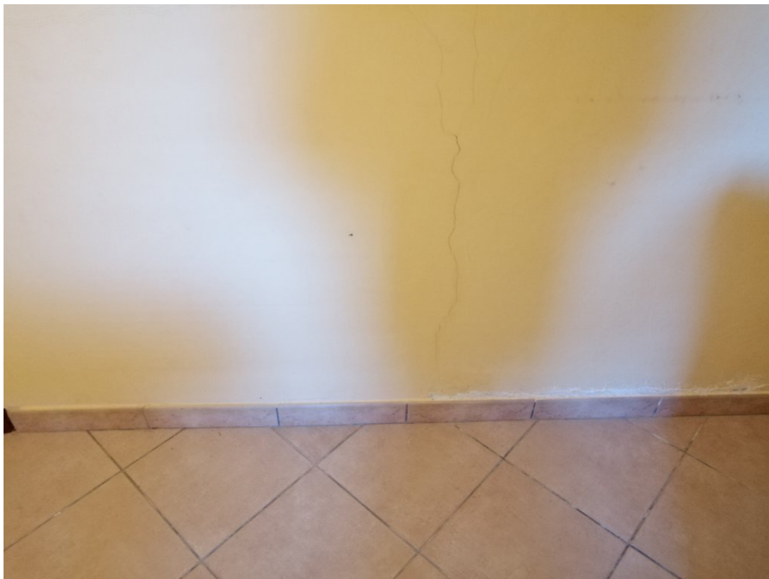
Foto 22 – Umidità di risalita nella cucina al piano terra.
