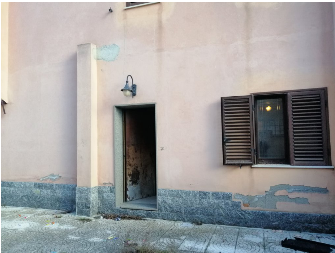
Foto 18 – Porta di ingresso particolarmente deteriorata.
