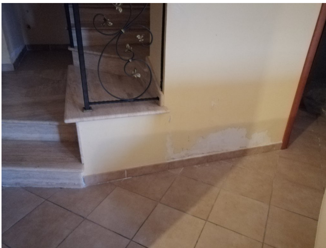
Foto 20 – Umidità di risalita nell'ingresso/soggiorno al piano terra.
