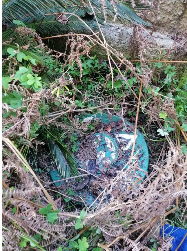
Foto 17 – Bombolone di GPL per il riscaldamento dell'appartamento.
