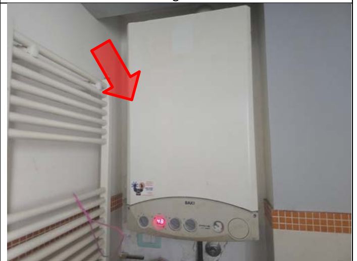
Bagno Particolare Caldaia
