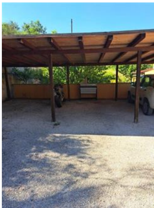
tettoia abusiva, su posto auto
