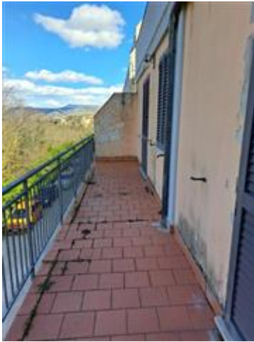
Terrazzo sul retro che necessita di manutenzione
