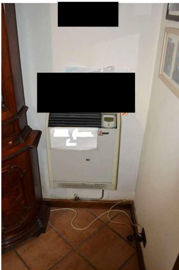
foto 2 - sub 2 (soggiorno-pranzo) – I corpi scaldanti rilevabili sono ventilconvettori allacciati a un sistema di distribuzione interamente fuori traccia.
