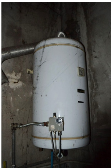
foto 18 - sub 1 (boiler) - Lo scaldabagno a metano, avente circa cento litri di capienza utile, è marca Boschetti con sensore bitermostatico incorporato. Il tubo fumi è fuori servizio e non si vedono adduzioni dirette, per cui è lecito supporre che il serbatoio funzioni come un puffer sanitario.
