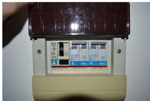
foto 21 - sub2 (ingresso) - Il quadro elettrico generale alloggia un differenziale di corretta taratura, con I_{\Delta n} = 0.03 A, e due magnetotermici: uno per la zona giorno, da 15 A, e l'altro per la zona notte, da 10 A. Nessuno degli impianti tecnologici risulta munito della dichiarazione di conformità, introdotta con la Legge n. 46/90, cioè molto dopo l'agibilità dell'edificio.
