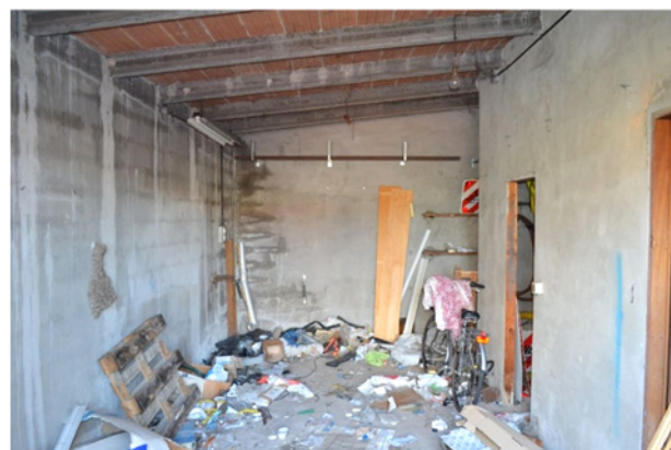
foto 14 - sub 1 (garage) - Il posto auto coperto esclusivo, con monofalda sottotegola e travetti tipo Varese, è difforme da quanto illustrato in atti. Anche qui ricorre il già citato art. 32, comma 2, del 380/01.
