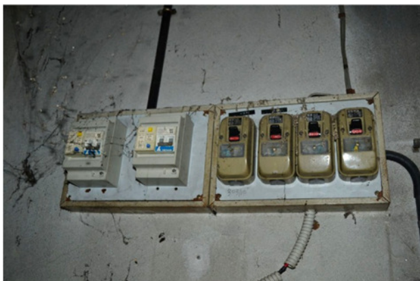
foto 15 - sub 1 (loc. boiler) - Il quadro elettrico asservito al secondo vano tecnico ha due differenziali (uno per la caldaia e l'altro per lo scaldacqua) di corretta taratura e quattro obsoleti magnetotermici.
