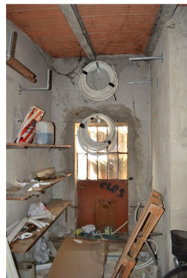
foto 19 - sub 1 (garage) - Dove l'accessorio esprime per intero la sua larghezza (4.87 metri) è solo verso il disbrigo che dà sulla porta posteriore. Quest'ultima, un infisso in metallo stampato inframezzato da vetri singoli, è ostruita dall'esterno da lastre ondulate e fa pensare di essere inutilizzata da tempo.
