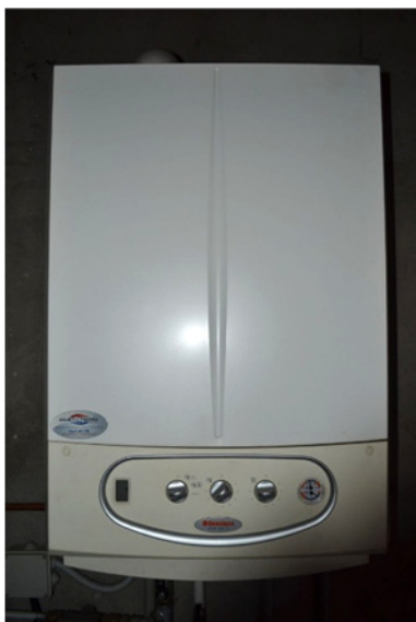
foto 17 - sub 1 (caldaia) - Il generatore di calore è un apparecchio murale da interni marca Immergas mod. Victrix Zeus 26, da 23.6 kW di potenza utile in riscaldamento, modulante e condensante. Incerti manutenzione periodica e denuncia al registro regionale degli impianti termici.
