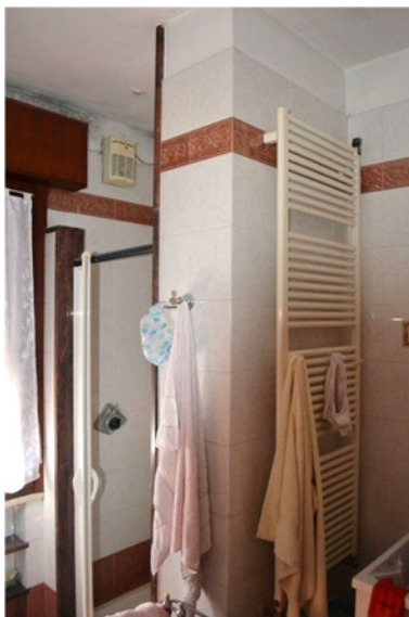
foto 11 - sub 2 (bagno) - La cabina doccia in muratura non figura né al catasto né in ufficio tecnico. Essa rappresenta una variazione non essenziale ex art. 32, c. 2, del DPR n. 380/2001.
