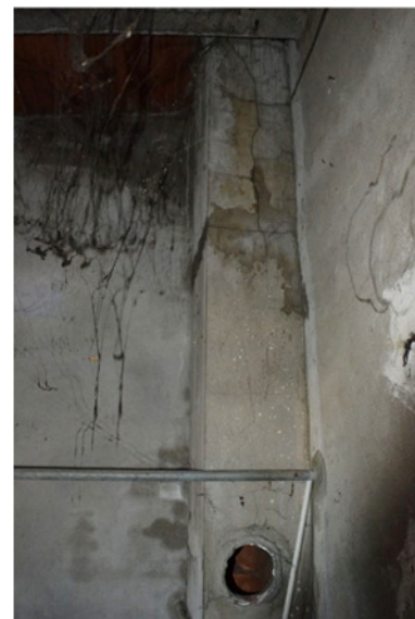
foto 12 - sub 1 (caldaia) - Il tubo fumi del generatore di calore, originariamente, correva in un canna fumaria strutturale ora inutilizzata. Attualmente la caldaia espelle a filo muro frontale.
