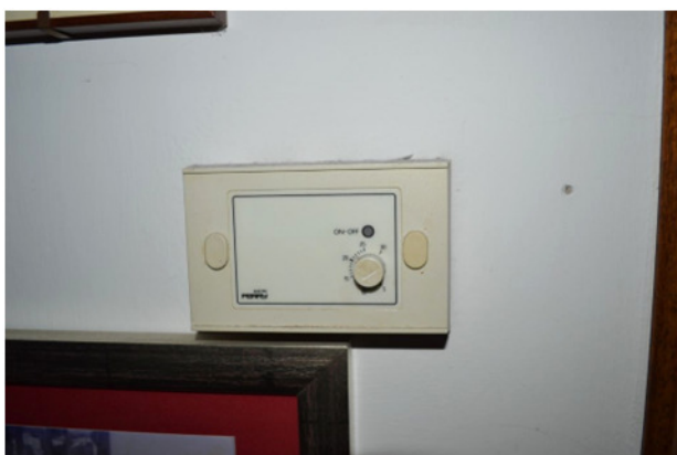
foto 13 - sub 2 (ingresso) - Gli unici due cronotermostati rilevabili si trovano nel vestibolo (quello in foto) e nel bagno, definendo così due zone termiche distinte. Si tratta di apparecchiature analogiche.
