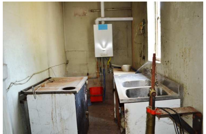
foto 33 - Il locale con la caldaia sopra il vano scala
