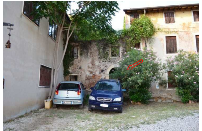
foto 11 - Prospetto sud dell'edificio collabente al n. 83
